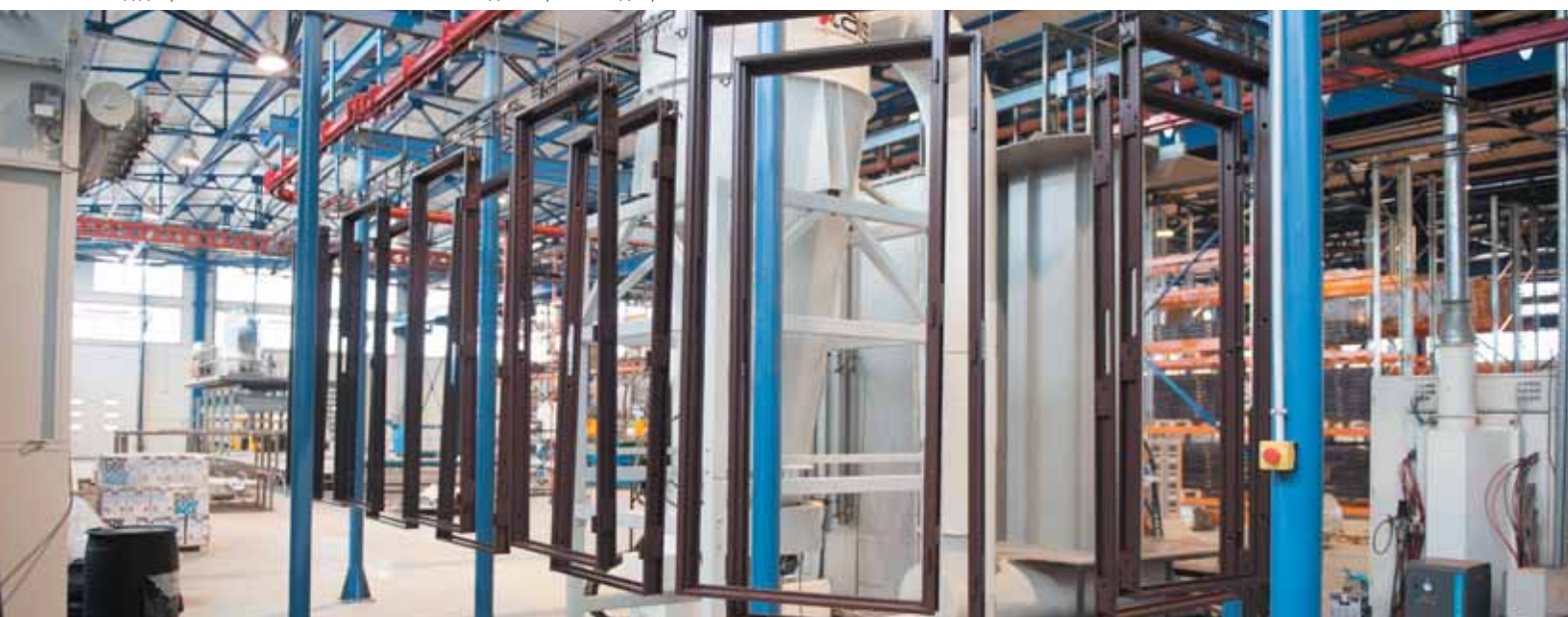
Завод дверных систем, цех окраски, автоматическая линия нанесения порошковой краски
