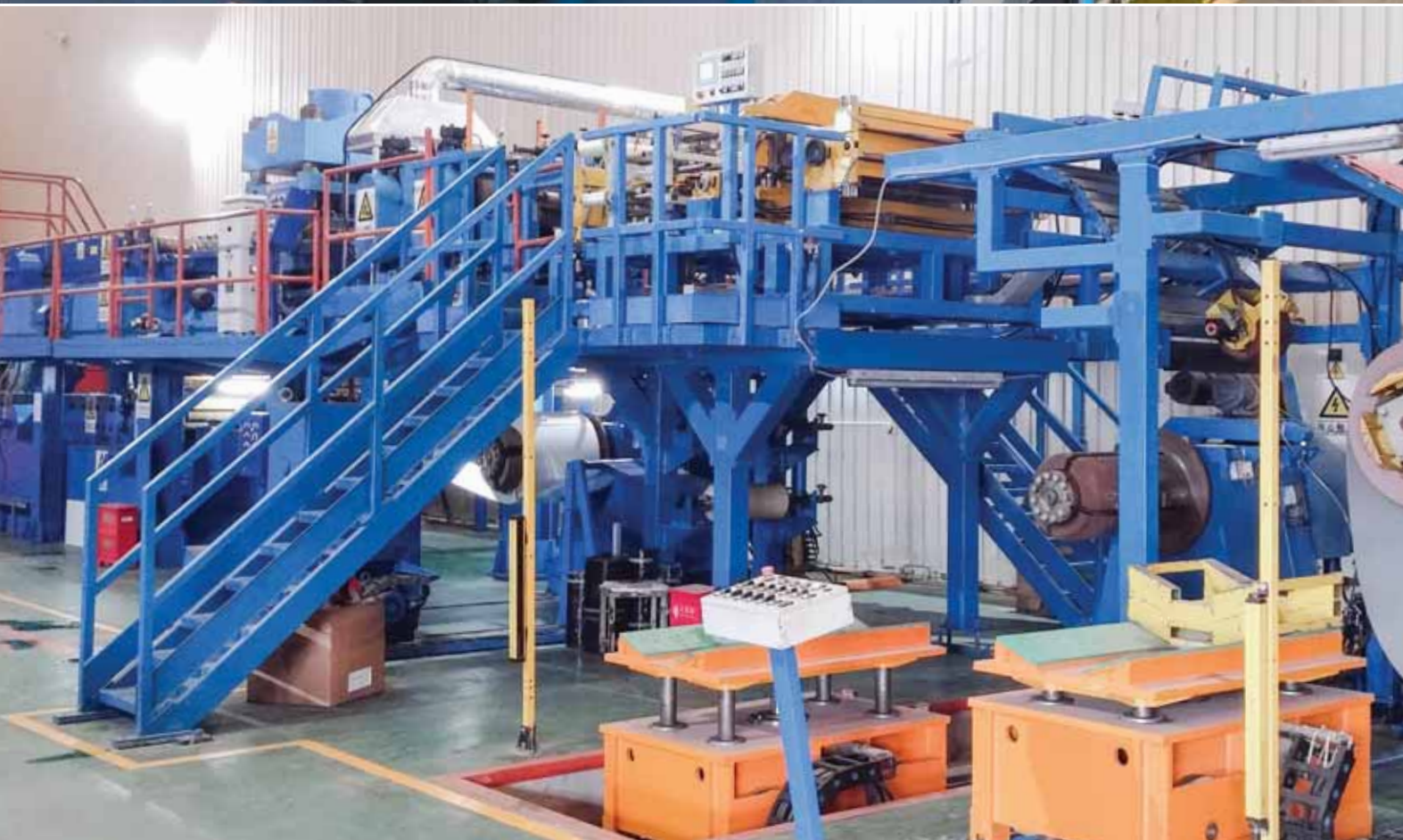
Завод воротных систем, автоматическая линия по производству сэндвич-панелей
