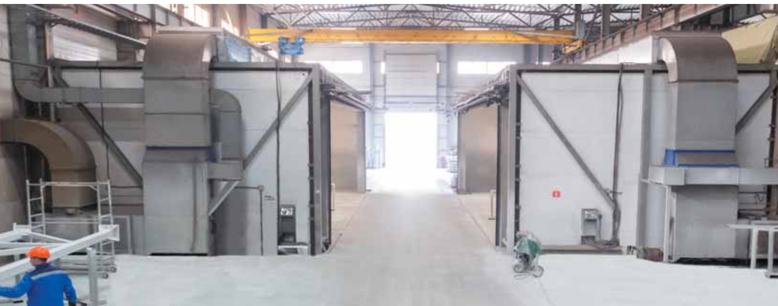
Завод полнокomплектных зданий, малярный участок
