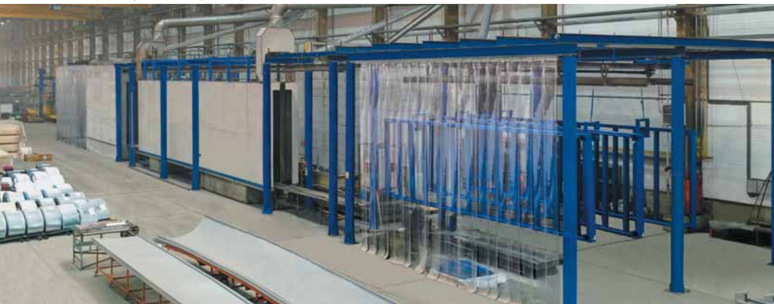
Завод блочно-модульных зданий, автоматическая линия порошковой окраски
