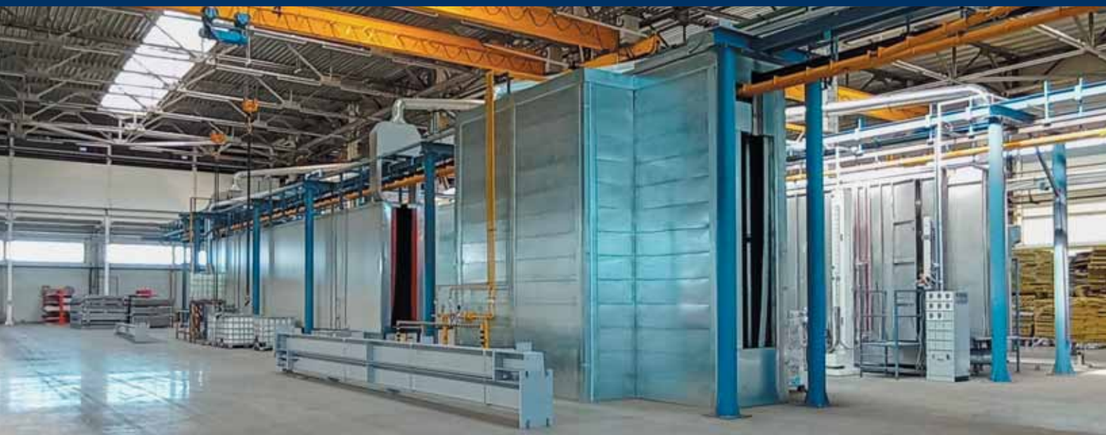
Завод блочно-модульных зданий, автоматическая линия порошковой окраски
