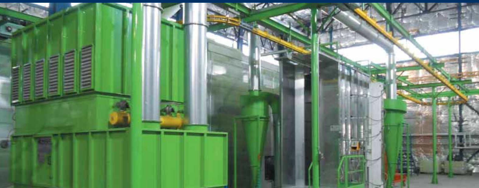
Завод систем ограждений, автоматическая линия порошковой окраски сеток
