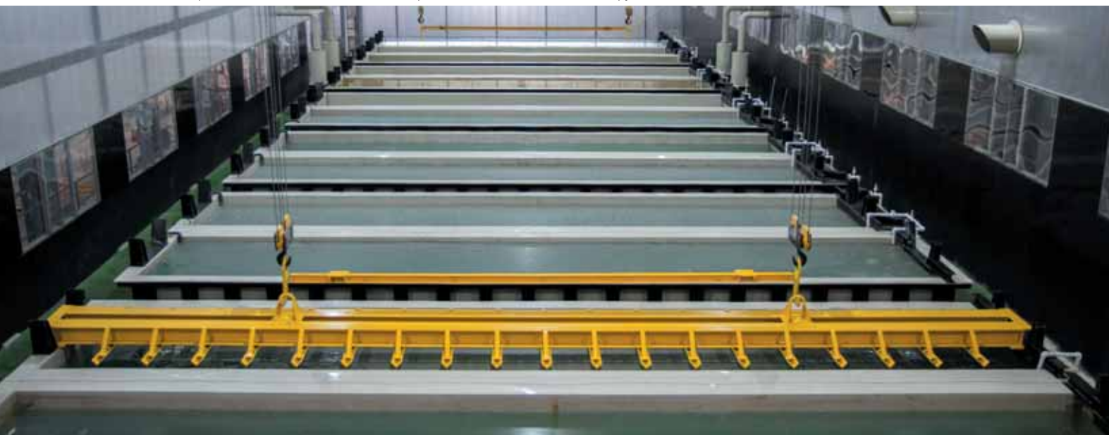
Завод горячего цинкования, ванны химической подготовки
