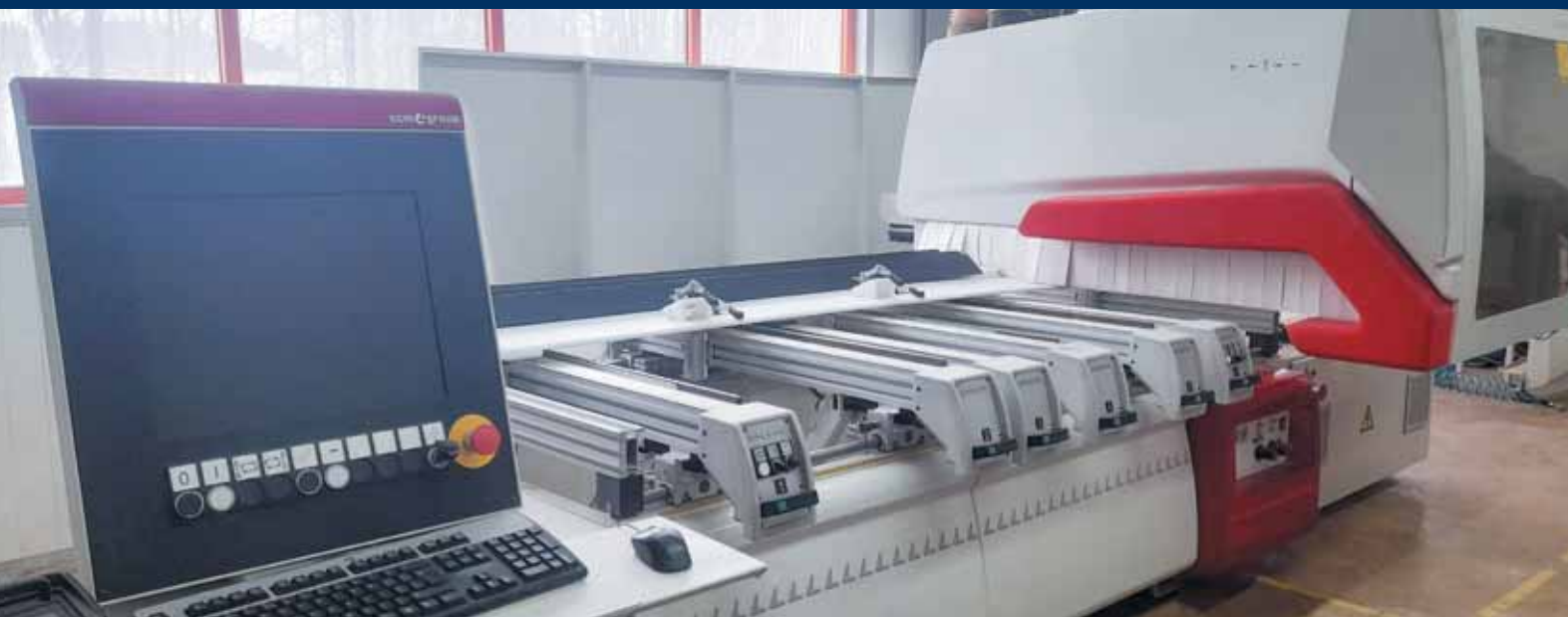
Завод дверных систем, оборудование для фрезеровки МДФ
