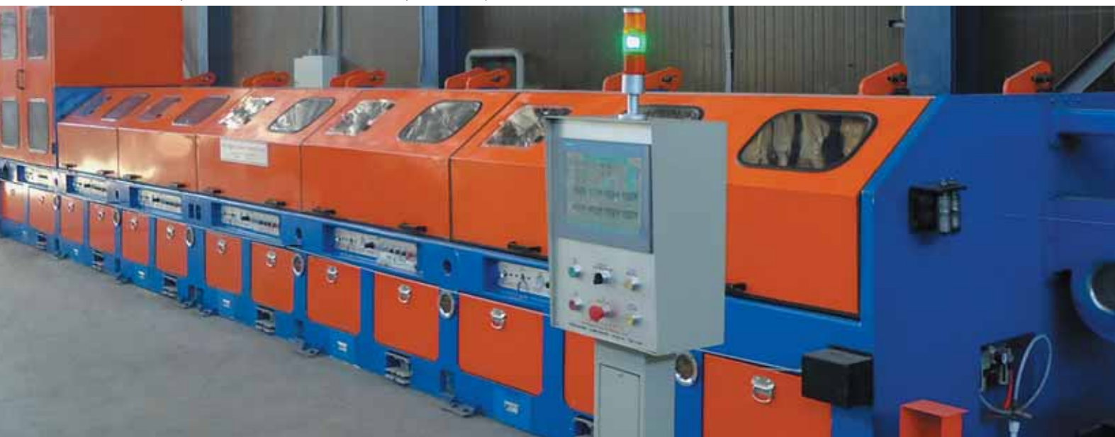
Завод систем ограждений, участок волочения
