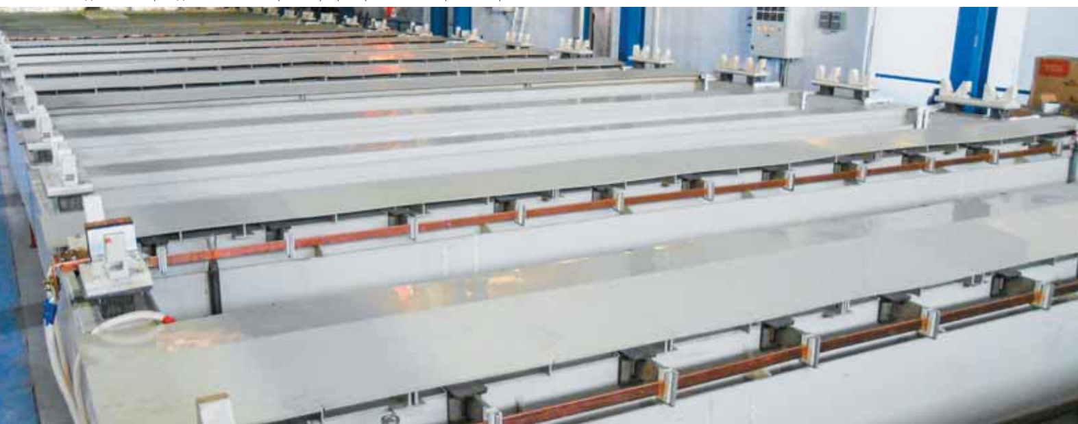
Завод систем ограждений, цех гальванической обработки металла
