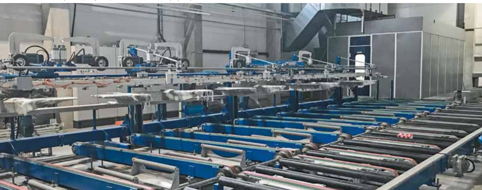
Участок складирования и упаковки сэндвич-панелей, камера окраски
