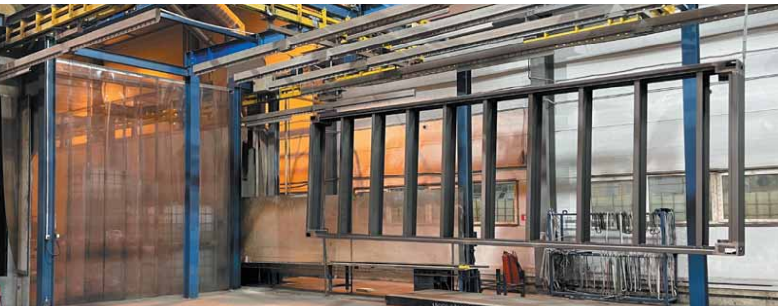
Завод блочно-модульных зданий, автоматическая линия порошковой окраски
