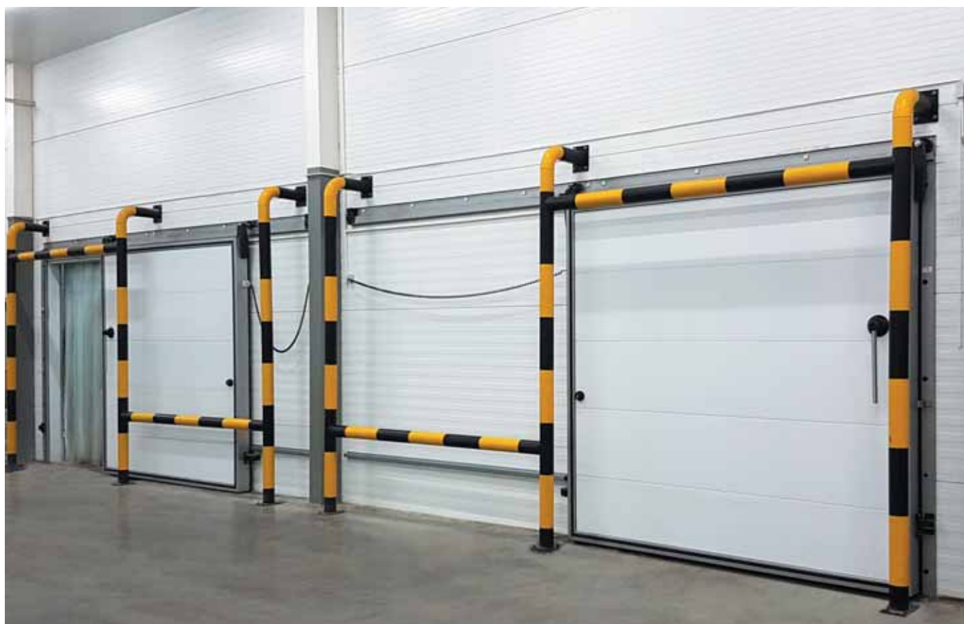
РОССИЯ, ВОЛГОГРАД. Низкотемпературный склад
